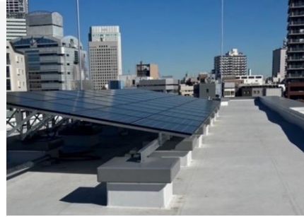
太陽光発電装置（屋上）
